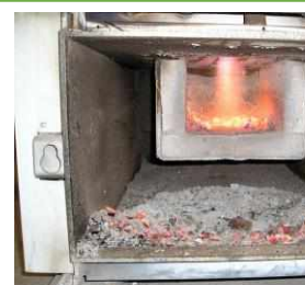
Горение угля в котлоагрегатах
